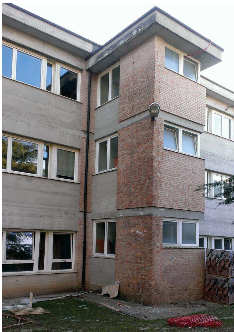
Vista dell'edificio scolastico con particolare sul volume che ospita i servizi igienici prima dell'intervento di riqualificazione energetica
