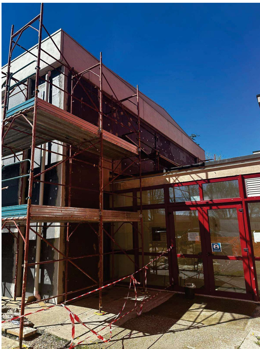
Vista del particolare del collegamento tra la palestra ed il corridoio che conduce alle aule.
