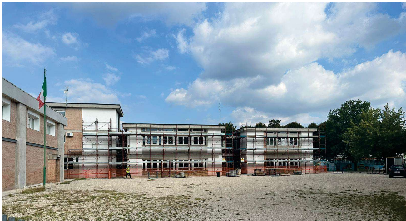
Vista del cortile retrostante dell'edificio scolastico e in adiacenza alla palestra durante i lavori di riqualificazione energetica
